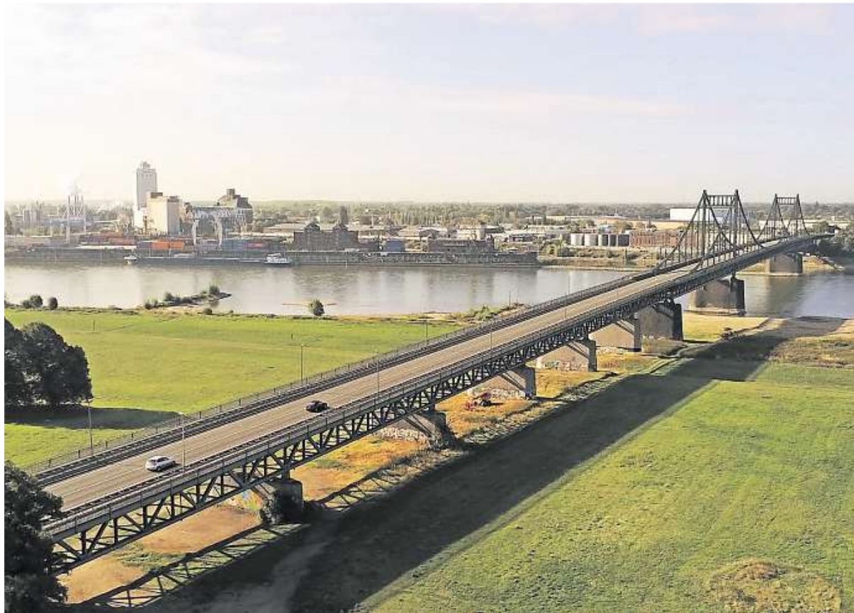
Die Rheinbrücke Krefeld-Uerdingen gilt als marode. Sie sorgt nunmehr seit knapp 100 Jahren für einen regen Waren- und Verkehrsaustausch zwischen Krefeld und Duisburg.
